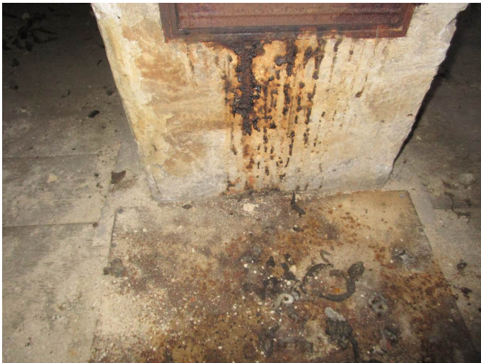
Abb. 7: Kotspuren eines Marders auf dem Dachstuhl des alten Wohngebäudes.
